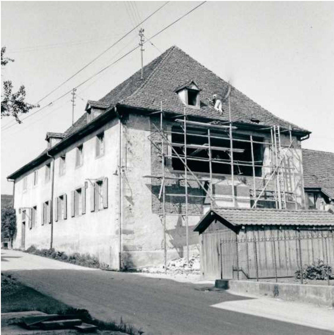
Alle Steine sind ausgebrochen, das Atelierfenster mit 2 Säulen verziert, Flaschenzüge demontiert Walter Gürtler hat alle Biberschwanzziegel aufs oberste Gerüstbrett getragen. Nun deckt er wieder das Dach, damit der Synagogen-Estrichboden vom Regen keinen Schaden nimmt. Der alte Verputz wurde abgeschlagen und sämtliche Umbauspuren mit neuem Verputz versehen. Foto Margrit Gürtler, 1967
